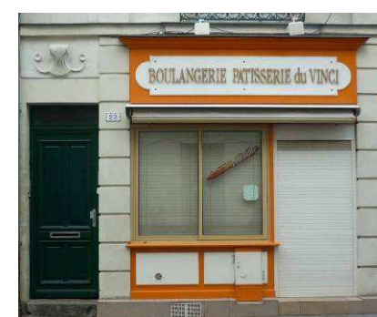
23, rue Bernard Palissy : volets roulants PCV intérieurs
