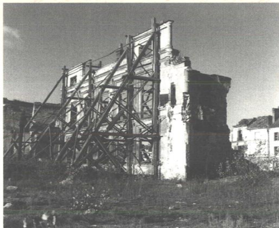
Fig. 13 : Etalement d'une partie de la façade de l'hôtel de Beaune Semblançay.
